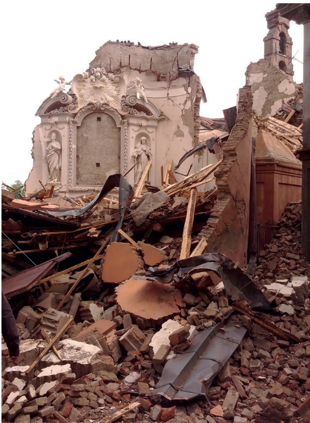
Fig. 4. Oratorio Ghisilieri (S. Carlo a Terre del Reno, FE), Sisma Emilia Romagna 2012. Esempio di lacuna definitiva dove la perdita è di tale entità da porsi fortemente il tema della riedizione critica del testo.
